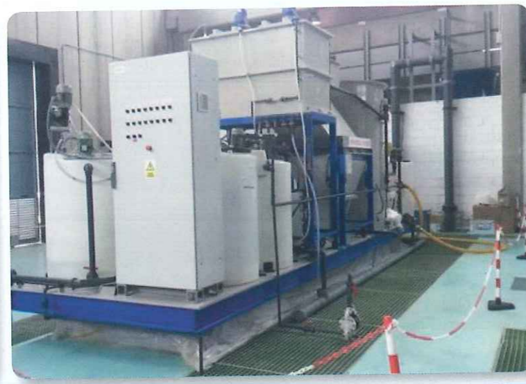
Figura 2b). Planta piloto de ZLD. | Figure 2b). ZLD pilot plant.
